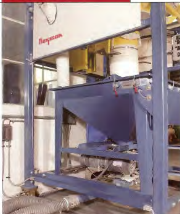
Unterhalb des Trichters auf dem Bulk-Bag-Entleerrahmen dosiert ein rotierendes Tropfventil das PVC-Harz für zwei pneumatische Fließbänder.
