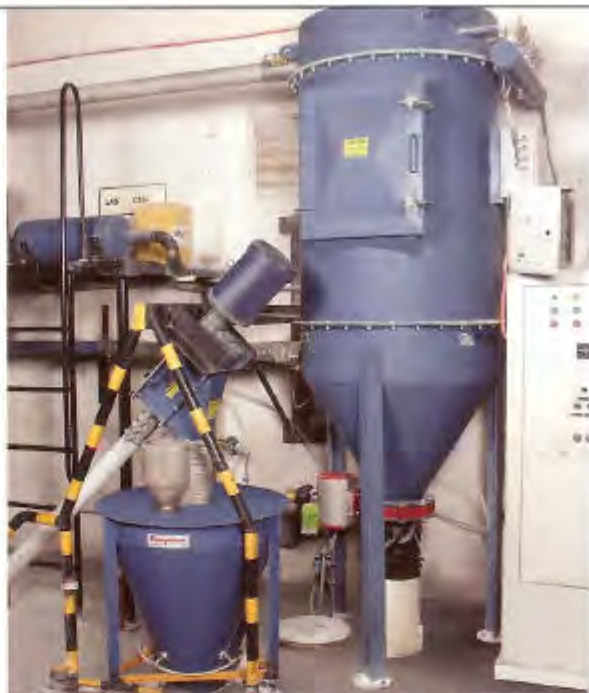
PVC wird pneumatisch zu einem Annahmefilter transportiert. Der Spiralförderer entleert \text{CaCO}_3 in einen Wiegetrichter. Beide Komponenten rutschen dann in die Mischanlage darunter.
