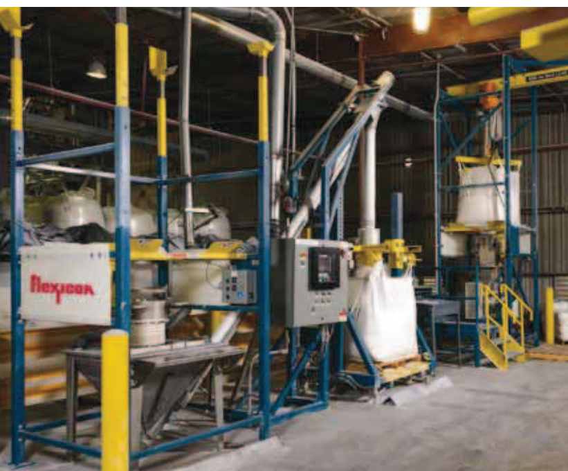
Deux déchargeurs de sacs d'expédition en vrac, un convoyeur à vis flexible, un chargeur de sacs d'expédition en vrac et des contrôles programmables permettent le reconditionnement de modificateurs PVC en trois formats de sacs d'expédition en vrac et en sacs de 23 kg.
