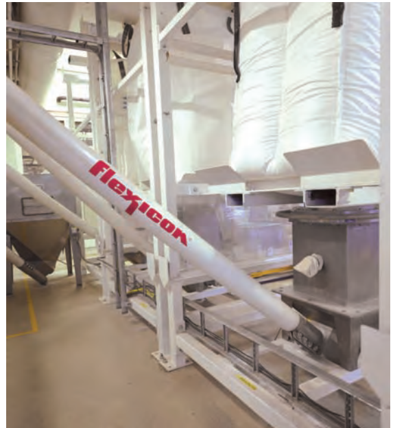
Wo eine Zuführung über die Schwerkraft nicht möglich ist, kommen andere Vorrichtungen von Flexicon zum Einsatz. Where gravity feeding is not possible, the plant is using bulk bag dischargers, flexible screw conveyors, rigid augers and pneumatic conveyors.
