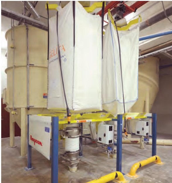
Die 1,2 Meter hohe Doppelkammer Big-Bag-Entleeranlage, die zwei Säcke nebeneinander bereit hält, liegt im vierten Stock der Fabrik. Nidar AS added twin half-frame bulk bag dischargers from Flexicon to handle two types of starch in a tight space on the plant's fourth floor.
